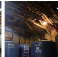
仕込みタンク
